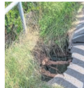
Vorsicht Loch: Teile im Randbereich sind bereits eingestürzt.
